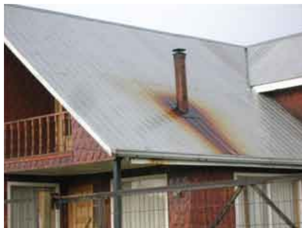
Cañón oxidado por humo y calor.
