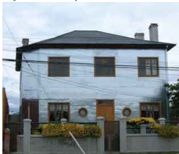
Abajo: Casa de zinc sin pintura.
